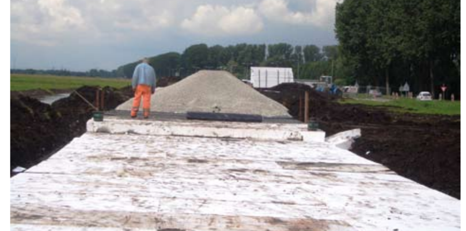
Aanleg van de evenwichtsconstructie met EPS (afgedekt met folie) en bims – voor de parallelweg van de N210.
